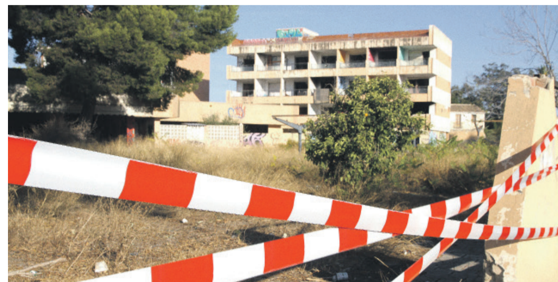
Las ruinas de la residencia de tiempo libre de Sant Joan d'Alacant
