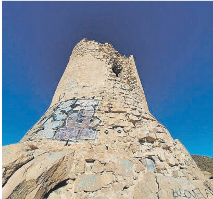
Estado crítico de la Torre de Reixes
