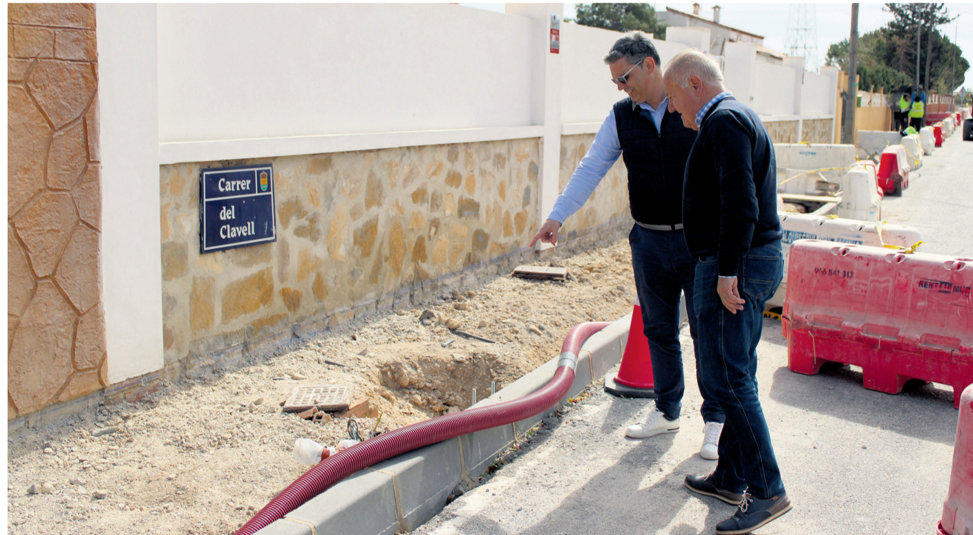
El concejal de Infraestructuras, José Antonio Bermejo, junto a alcalde Sebastián Cañadas, en la visita a Los Girasoles
