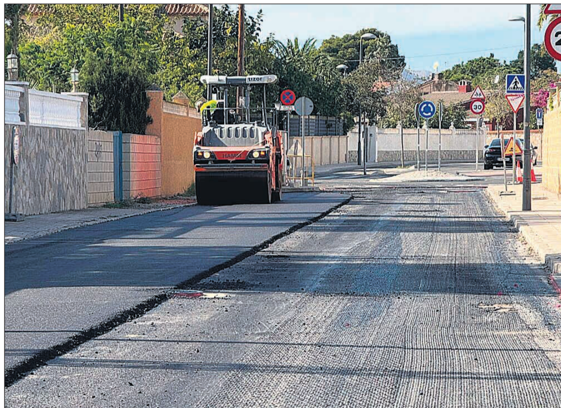
Imagen de una de las obras de asfaltado de una calle de San Vicente
