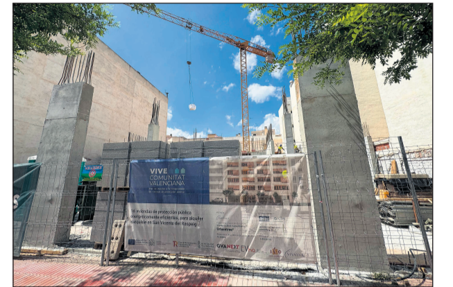
Los dos inmuebles que se encuentran en la calle la Huerta número 9 y 150, respectivamente
