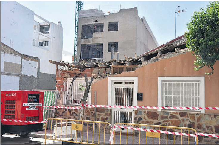
Imagen de la fachada de la vivienda que sufrió el derrumbe
